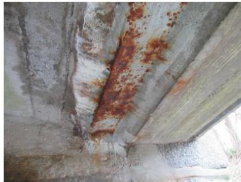
3. Svær korrosion på underside af brodæk fra indstøbte stålprofiler.
