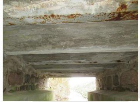
2. Underside af brodæk, rust på stålprofiler.
