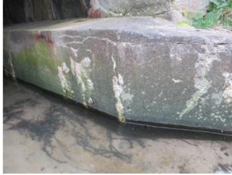
1. Revner med kalk- og rustudfældninger på endeunderstøtninger.
