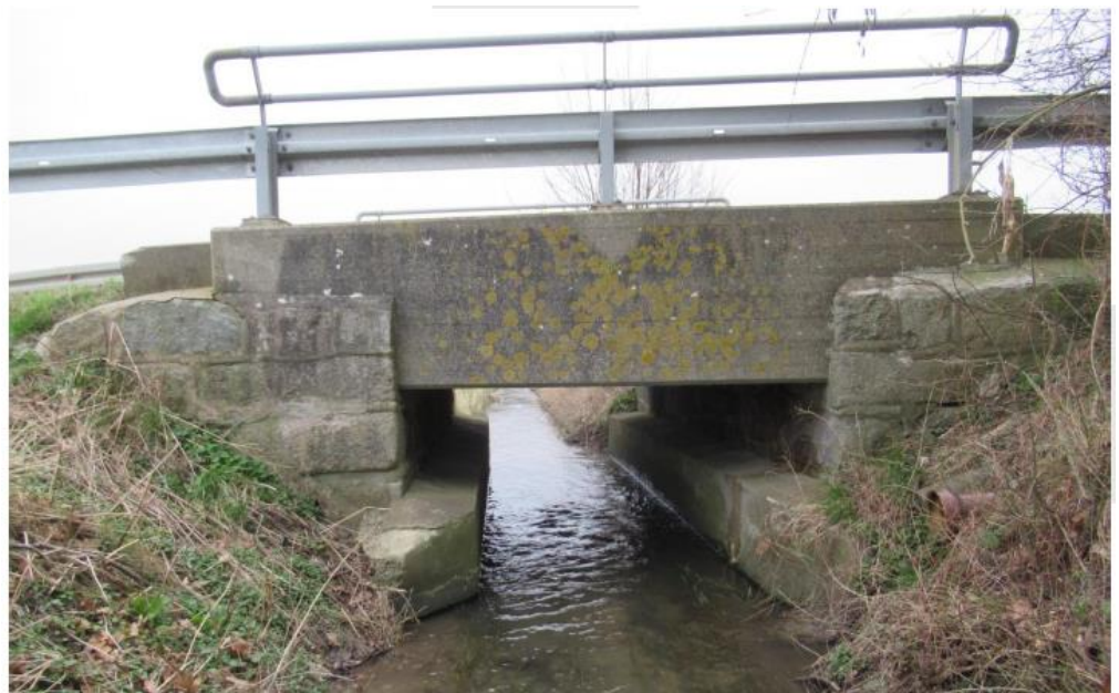
Figur 1. På Øverste billede ses Ellebæk nedstrøms broen. På nederste billede ses broen fra vandløbssiden. Denne bro skal udskiftes.
