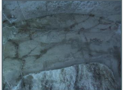
4. Kraftige netrevner på endeunderstøtning.
