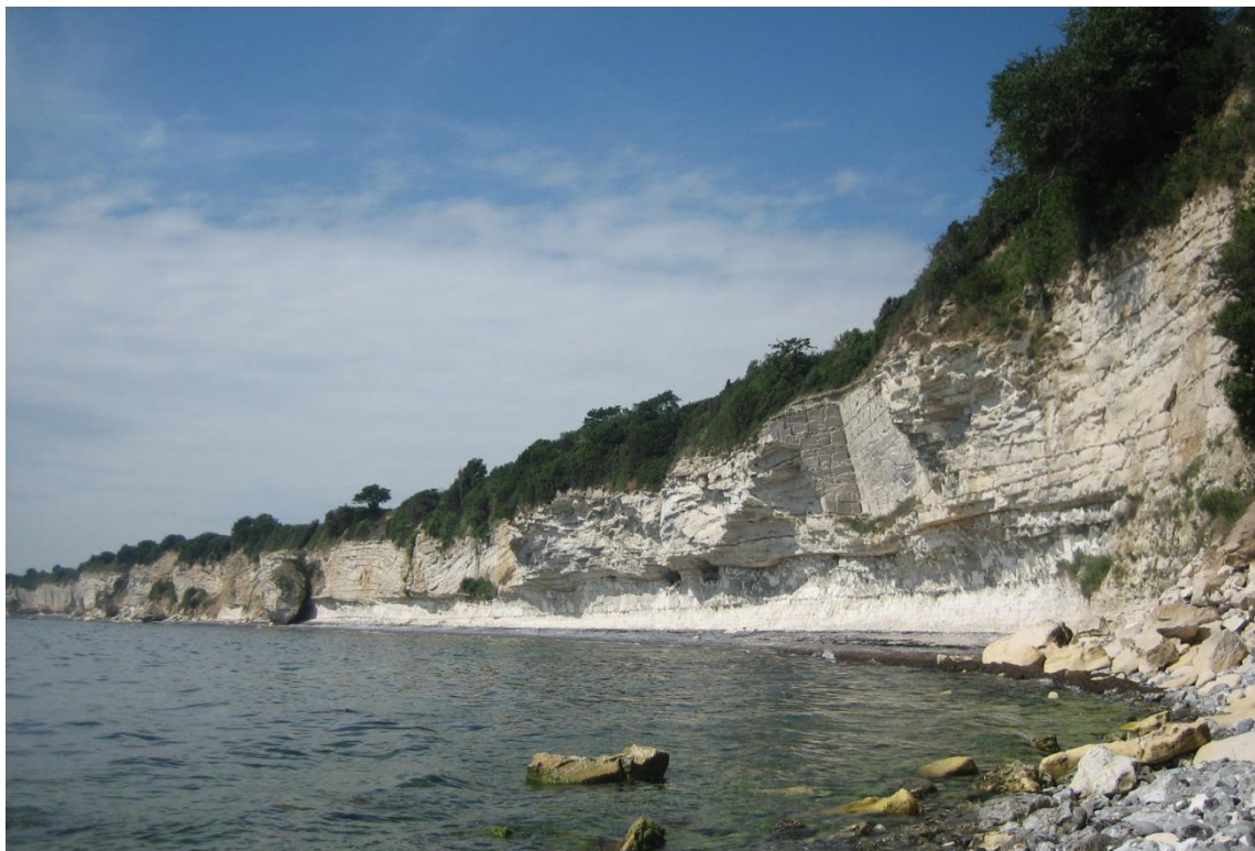
Figur 69. Den indre del og sydklinten af Harvig. Bryozokalken er her ret tyk (15 m), hvilket vil gøre overhængen relativt stabilt. Dog vil det gamle hjørne af det gamle kalkstensbrud, som ses tæt ved forgrunden, kunne blive udsat for et blokfald inden for nogle få år.
