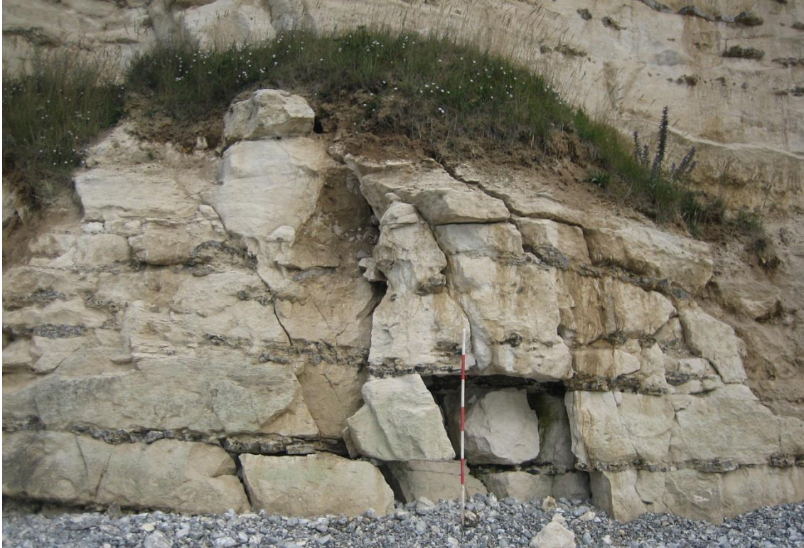
Figur 43. Det markante ØSØ-strygende sprækkesystem som styrer klintkystens retning nord for Rødvig. Sandsynligvis er den stejle hældning mod NNØ med til at skabe overhængene langs med kysten, og dermed den karakteristiske erosion, som udløser flagebræk.
